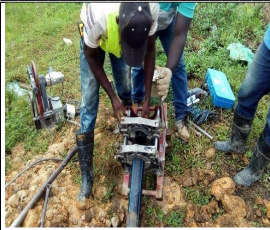
Tubo instalado en Citronela
