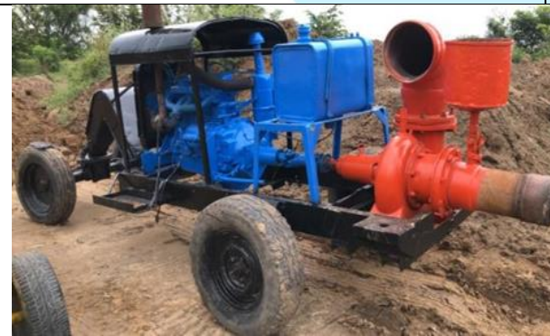
EQUIPOS DE BOMBEO UTILIZADO PARA EL MANEJO DEL NIVEL FREATICO.
