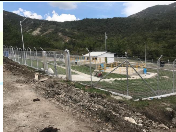
Avance en acondicionamiento de la zona de entrada y perimetral a la PTAP
